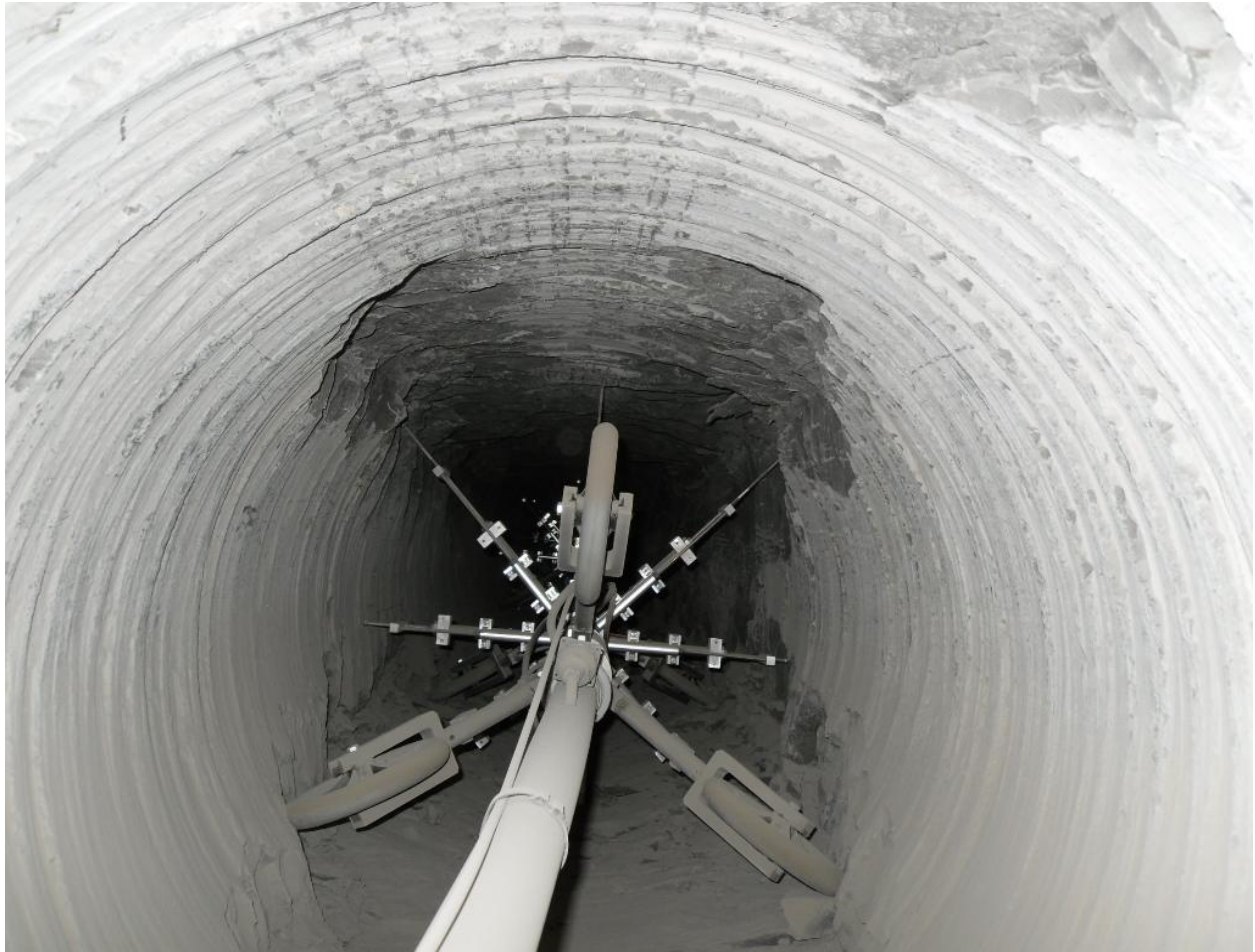
Figure 6-1 : Hors-profil par rapport à la forme circulaire d'un forage dans le laboratoire souterrain de Bure. Photo prise par Krishan Wahi, 18 août 2010.
