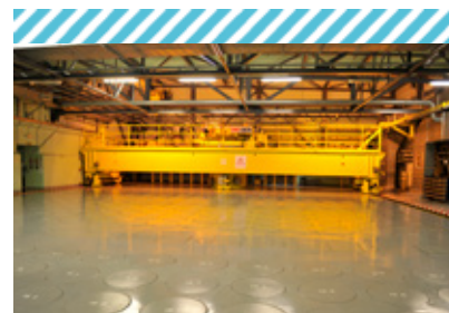
Hall d'entreposage de déchets vitrifiés de haute activité - établissement de La Hague
